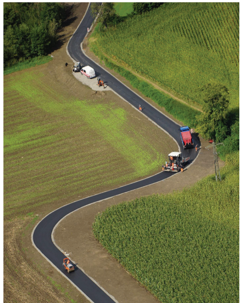
Der neue Radweg von Owingen nach Bambergen wurde nicht entlang der Kreisstraße, sondern auf der vorhandenen Trasse eines Feldweges gebaut und asphaltiert. Der Radweg ist 2,9 km lang und kostete 2,1 Mio. Euro (Anteil Radweg). (Ira)
