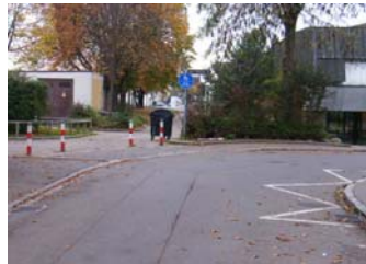
Vorher: An der Hans-Schnitzler-Straße war ein Slalom um Posten und Mülltonnen angesagt, die Absenkung war mangelhaft.
