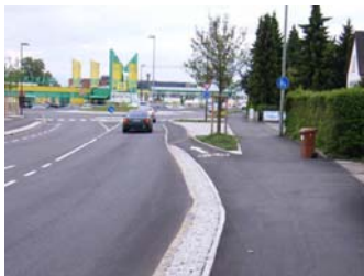
Die Ausleitung auf den Kreisverkehr der Rheinstraße stadteinwärts ist unnötig schmal geraten (1,5 m Breite) und hat einen unharmonischen Verlauf.
