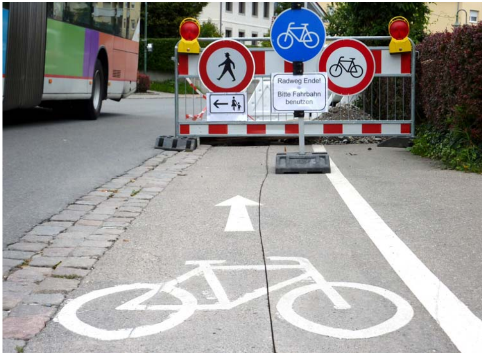
Bei Baustellen, hier am Bodensee-Radweg in Immenstaad, zeigt sich der Stellenwert des Radverkehrs: Radfahrer werden abrupt ausgebremst. Eine gelb markierte Ausleitung auf die Fahrbahn und Tempo 30 während der Bauzeit wären die bessere Lösung gewesen.
