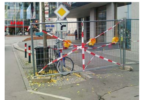
Beispiel einer unüberlegten Baustellenplanung: Radler werden - statt auf einen Radweg geführt - brüsk abgewiesen (Bahnhofplatz Konstanz Richtung LAGO).
