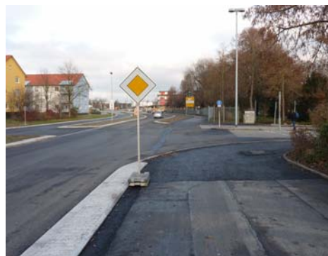
Nachher: Der Radweg führt nun geradlinig über die Einmündung. Später wird die Option bestehen, auf einem Schutzstreifen in den geplanten Kreislauf zu fahren.
