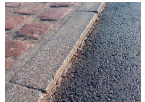
Bei der Sanierung der äußeren Pflastersteine und durch eine neue Asphaltdecke entstand ein Höhenabsatz von ca. 2 cm. Dies ist zu wenig um das Überfahren durch Kraftfahrzeuge wirksam zu verhindern.
