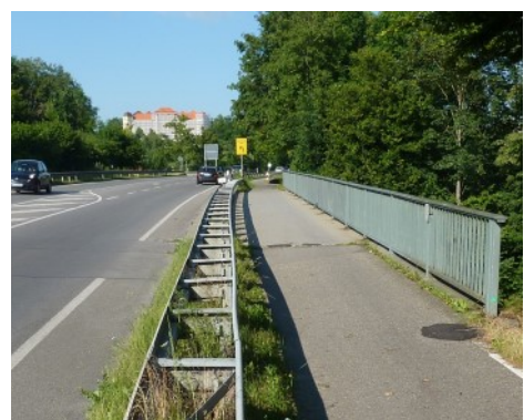
Vorher: Der Radweg an der L 333 westlich von Tettngang bei der Brücke über die B 467 war nur 2,0 m breit.
