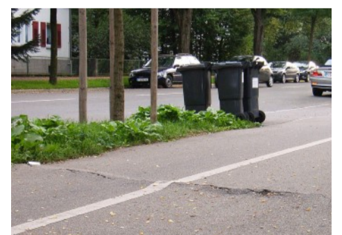
Am Radweg der Paulinenstraße sind Wurzelaufbrüche ein Ärgernis für Radfahrer. Eine Lösung ist dringend erforderlich.
