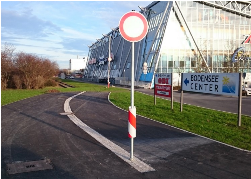
Am neuen Kreisverkehr der Meisterhofener Straße ist der Beginn des Velorings bereits erkennbar. Er wird am ehemaligen Industriegleis entlang zur Mühlöschstraße führen.
