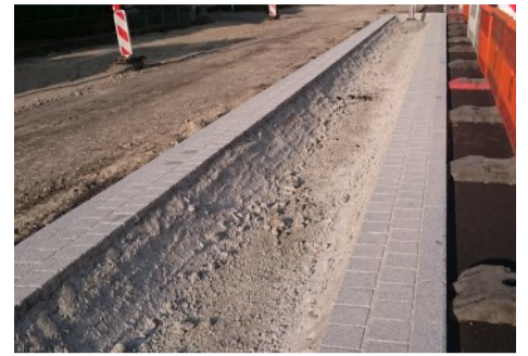
So sah der zu schmal geratene Mittelstreifen der Keplerstraße in der Bauphase vor der „Begrünung“ aus: Ein nachhaltiges Wachstum der Alleebäume ist in dieser schmalen Betonrinne kaum möglich. Auch das eine vermeidbare Fehlplanung. (bg)
