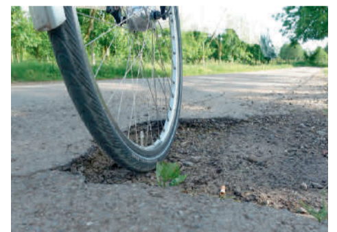
Schlaglöcher wie hier bei Tunau sind keine gute Visitenkarte für den Bodensee-Radweg und außerdem gefährlich.
