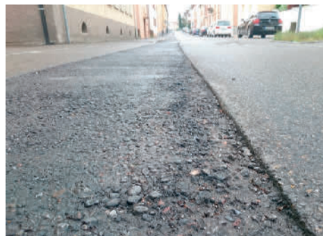
2016 wurde der Belag in der Hofener Straße provisorisch geflickt. Er sollte „in Bälde“ saniert werden. (bg)
