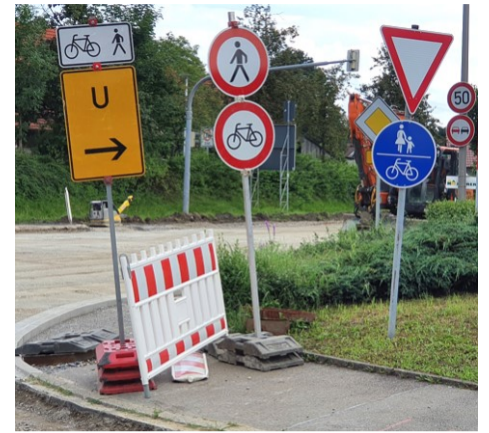
Als Rätselaufgabe installierte die Baufirma einen interessanten Schilderwald. (bg)
