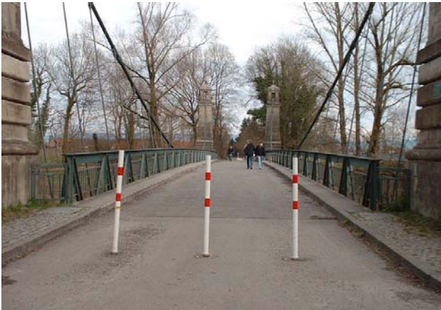
Bild 32 Kabelhängebrücke über die Argen Der Abstand der Pfosten (1,0 m) war viel zu eng.
