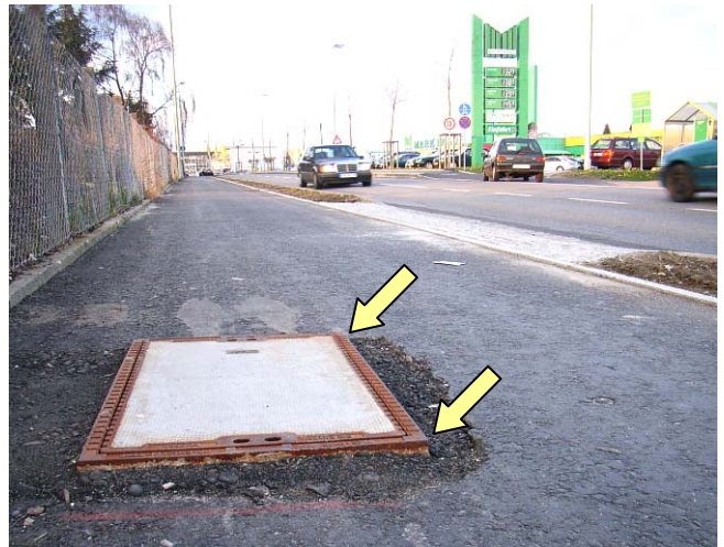
Bild 12: Herausragender Kanaldeckel im Radweg (gegenüber ZF-Einfahrt)
