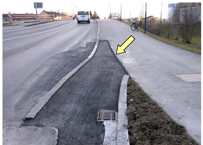
Bild 14: Besonders gefährlich war diese Kante mit spitzem Winkel zur Fahrtrichtung bei der Ausfahrt aus dem Komm-Kreislauf stadteinwärts
