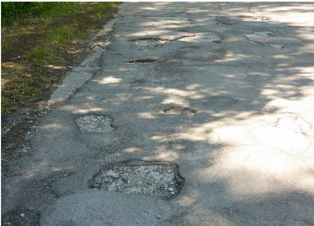
Bild 13: Schlaglöcher in der Fahrbahn
