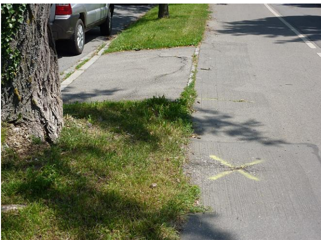
Bild 35: Wurzelaufbruch an der Paulinenstraße
