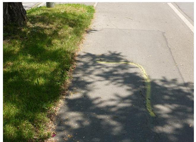
Bild 36: Wurzelaufbruch an der Paulinenstraße
