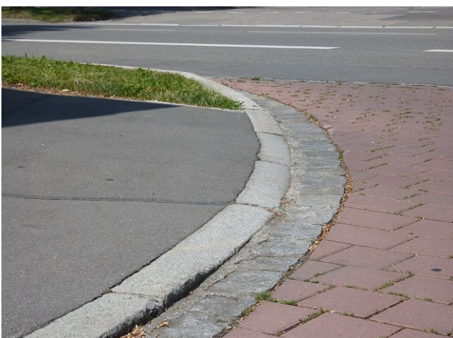
Bild 16: Unzureichend abgesenkter Bordstein an der Einmündung der Georgstraße
