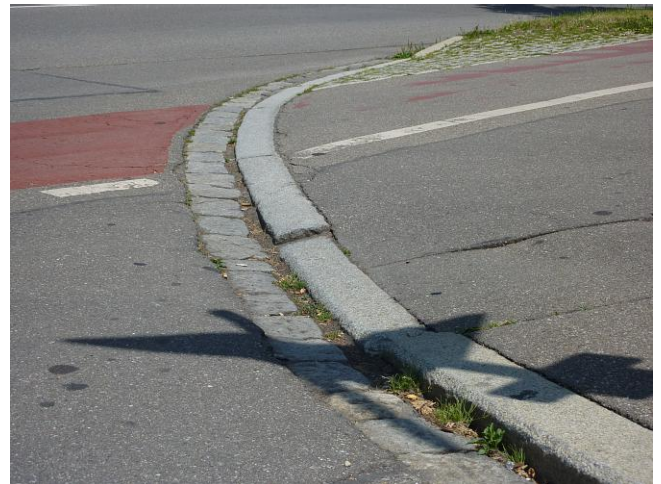
Bild 5: Mangelhaft abgesenkter Bordstein an der Einmündung der Kleinebergstraße
