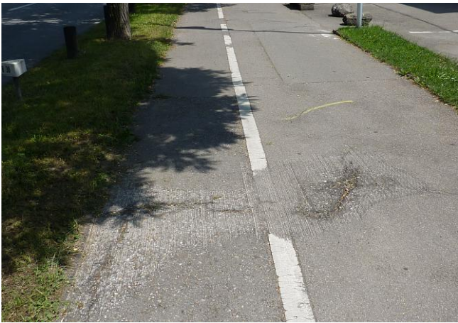
Bild 37: Wurzelaufbruch an der Ravensburger Straße
