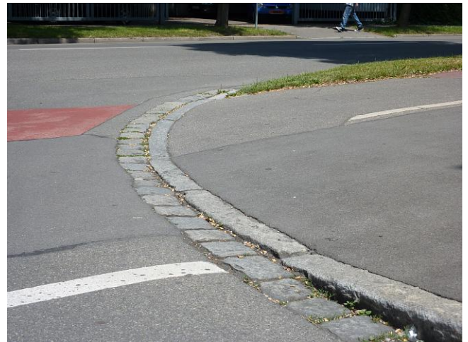
Bild 9: Unzureichend abgesenkter Bordstein an der Einmündung der Werderstraße
