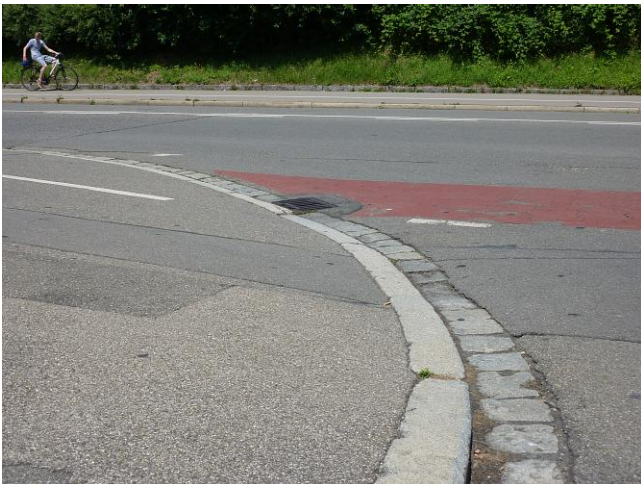
Bild 4: Mangelhaft abgesenkter Bordstein an der Einmündung der Kleinebergstraße
