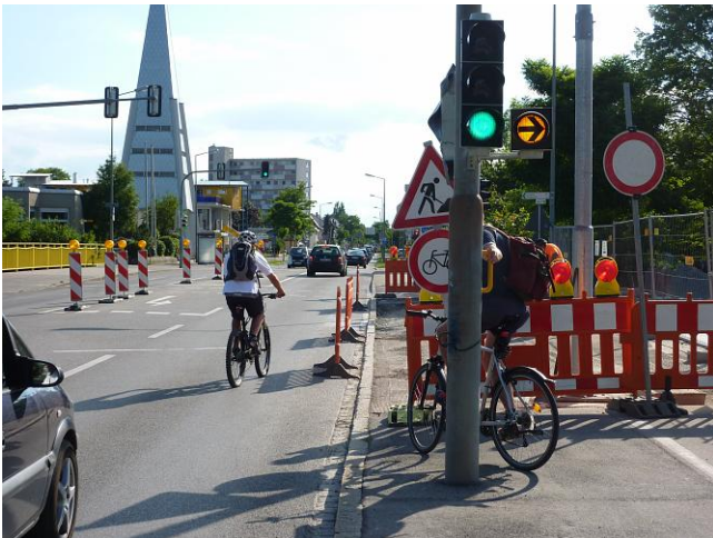
Bild 46b: Der Radverkehr fährt ohne gesicherte Einleitung auf die Fahrbahn der Ravensburger Straße
