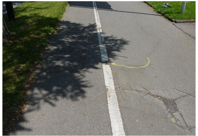
Bild 38: Wurzelaufbruch an der Ravensburger Straße
