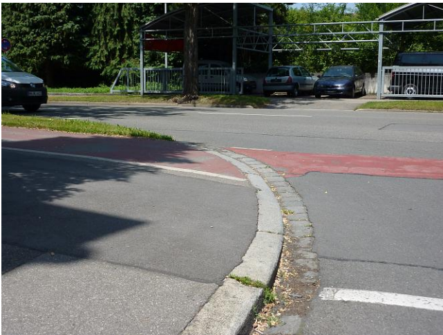
Bild 8: Unzureichend abgesenkter Bordstein an der Einmündung der Werderstraße
