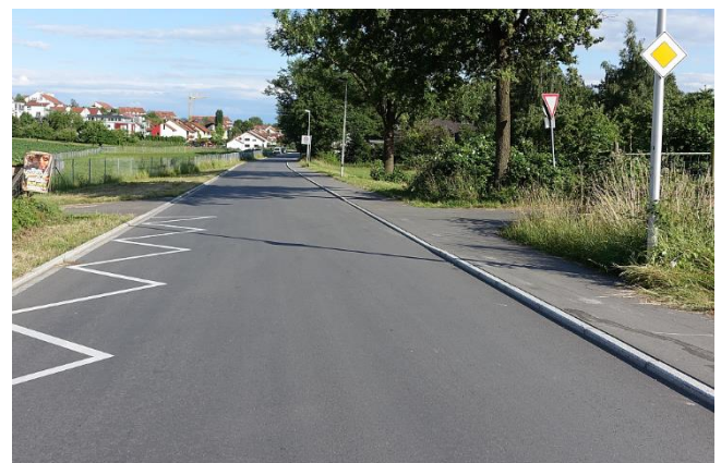
Bild 12: Der Bordstein bei der Einmündung des Verbindungsweges in die Glärnischstraße sollte auf Null abgesenkt werden.
